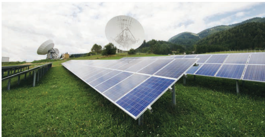
Photovoltaikanlage bei der Erdefunkstelle Aflenz.
